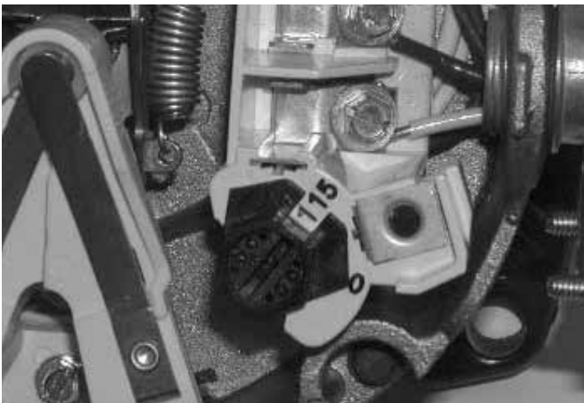
Figura 13: Motor configurado para una operación a 115 Voltios
